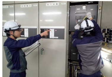
変電設備保守
