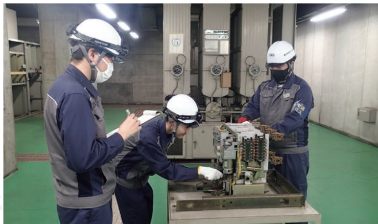
変電設備の保守点検 ▶
